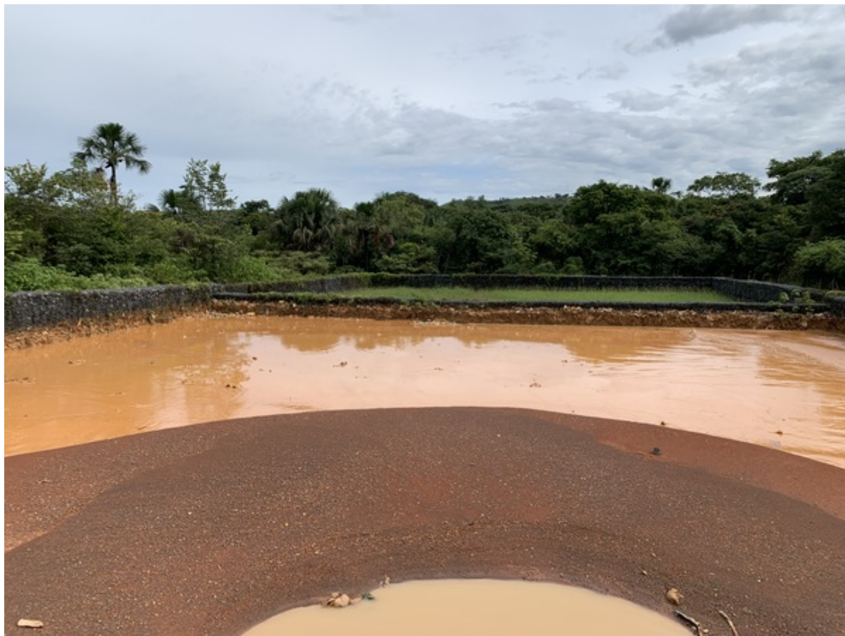
Figura 2 - Reservatório de Qualidade do sistema de drenagem pluvial do ASB.
