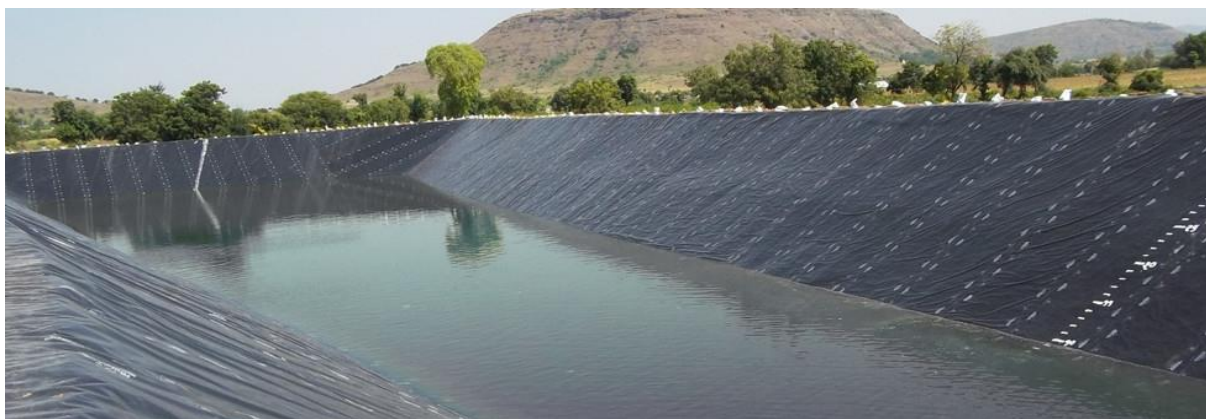
Lagoas de tratamento de efluentes
